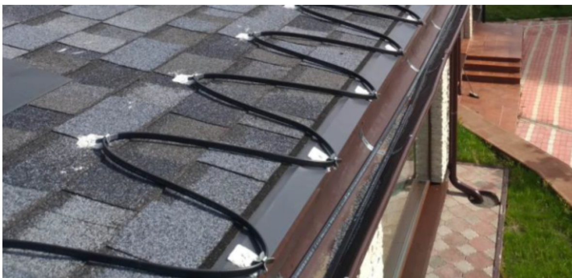
Проблемный участок крыши. Кровля - катепал.
